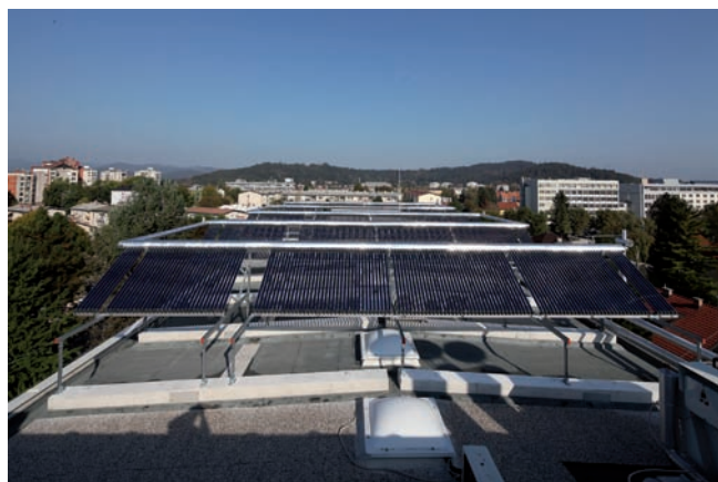
Slika 3: Pogled na sončno toplotno kolektorsko polje (tip „roll-bond“) na IJS v Ljubljani (avtor fotografije M. Smerke)
