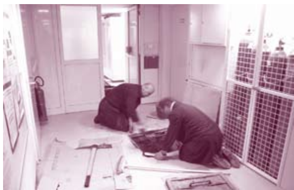
Slika 1. Stane Cvelbar in Franci Skopec v akciji v kleti glavne stavbe, ko je malo ponagajala kanalizacija
